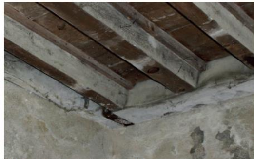
Bâtiment B, éléments métalliques rouillés
