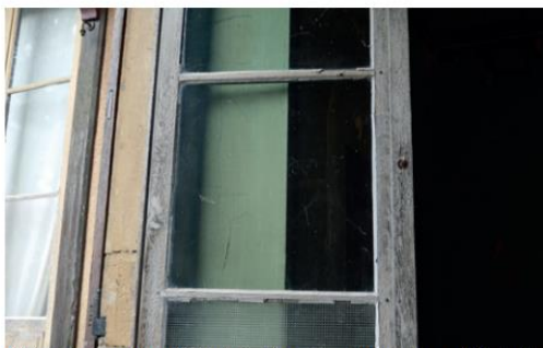
Bâtiment A, cuisine, joints très dégradés et éléments rouillés, teinte abîmée
