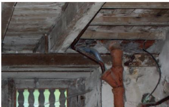
Bâtiment C, poutre rouillée visible depuis l'atelier
