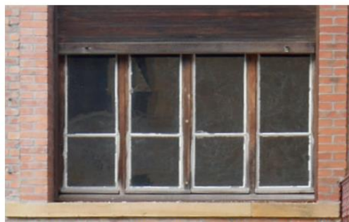
Bâtiment C, bibliothèque, dégradation de la fenêtre à quatre vantaux
