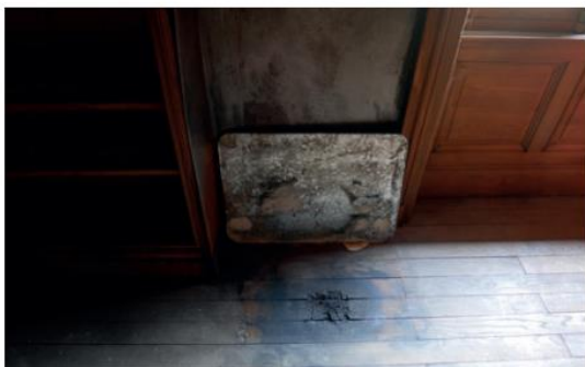
Bâtiment C, bibliothèque, parquet brûlé
