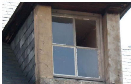
Bâtiment A, lucarne nord-ouest, joints dégradés et vitre manquante
