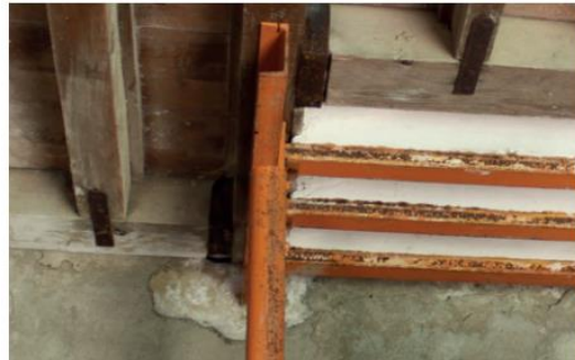
Bâtiment B, éléments métalliques rouillés
