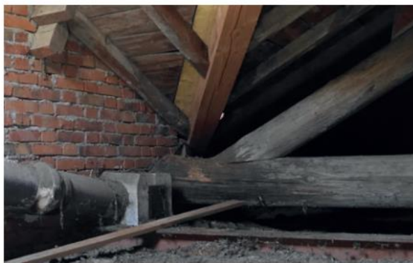
Bâtiment C, charpente dégradée
