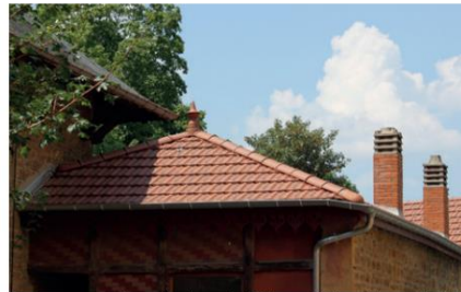
Couverture en tuiles mécaniques du bâtiment B, des arêtiers et de l'épi de faîtage en terre cuite
