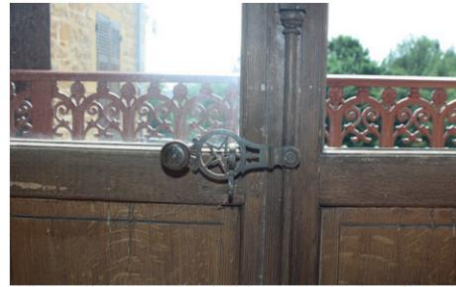
Salle de musique, espagnolette d'origine. A noter : la peinture faux-bois couvre l'élément métallique
