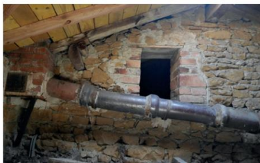
Combles du bâtiment C, baie donnant sur les combles du bâtiment B
