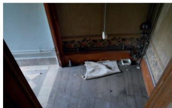
Entrée des sanitaires, abritant une chaudière récente
